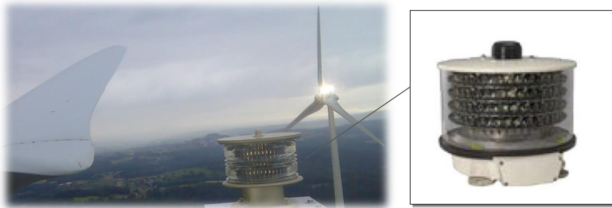
Figure 38 : Balisage d'une éolienne
